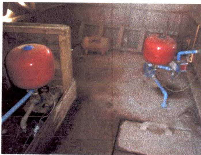
Foto 3: Sistemas Hidropack, izquierda suministra Liceo,
